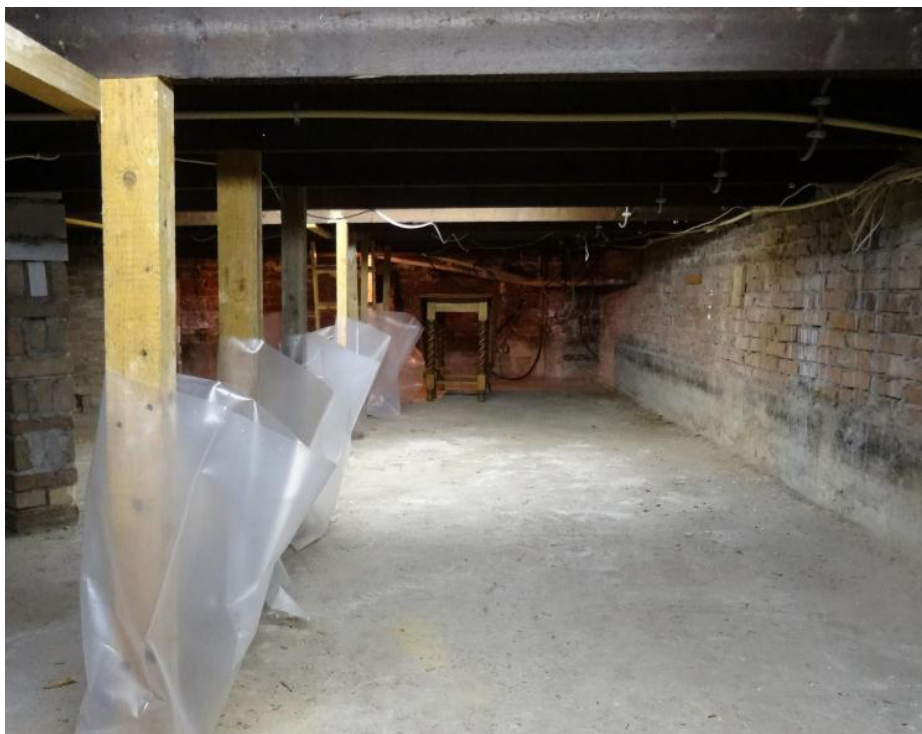
Een ongeïsoleerde kruipruimte.
