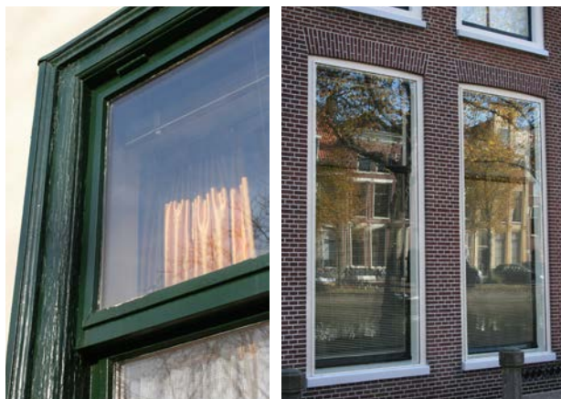
Links: Enkelglas wordt bevestigd door middel van stopverf. Een glaslat aan de buitenzijde verandert het historisch aanzicht. Rechts: Voorzetramen aan de buitenzijde
